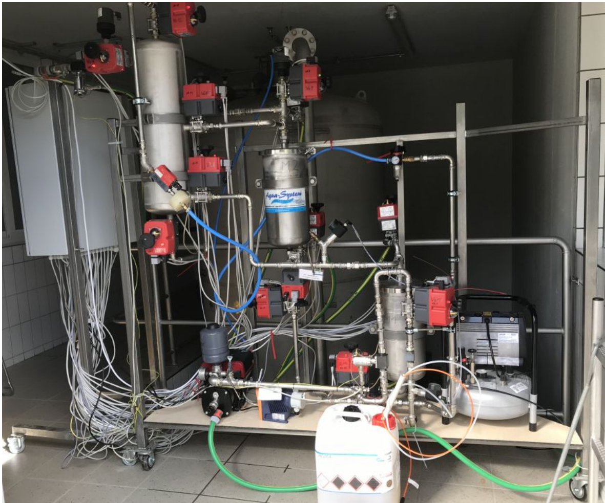
Abbildung 54: Versuchsanlage am Aufstellungsort des Feldtests
